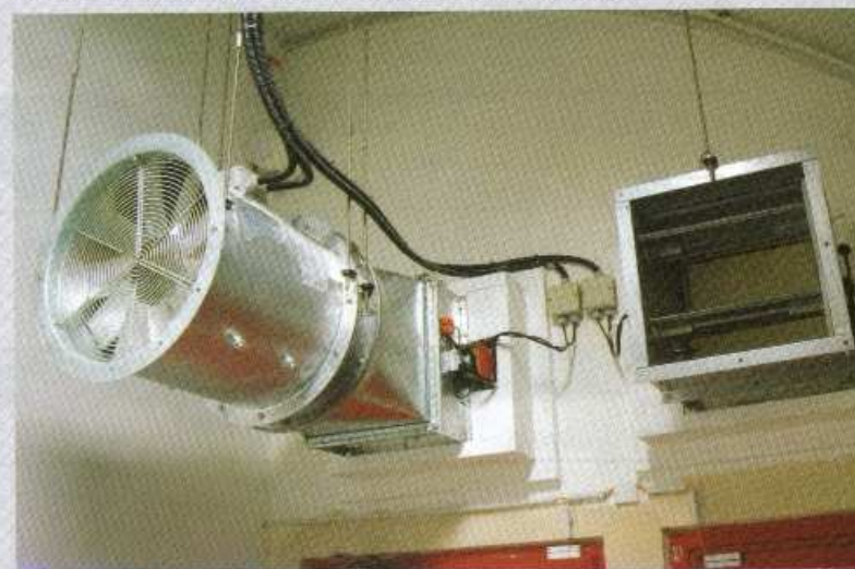
▼ Obr. 2. Přetlakové větrání únikové cesty v tunelu Klimkovice
